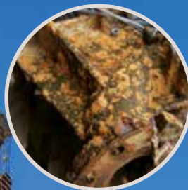
CORROSIÓN POR QUÍMICOS
